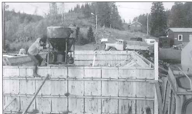
Starten på bygginga av nytt klubbhus i Blommen. Per Olav Helden tømmer mørtel i forskalinga. I bakgrunnen ser vi den gamle klubbhytta
